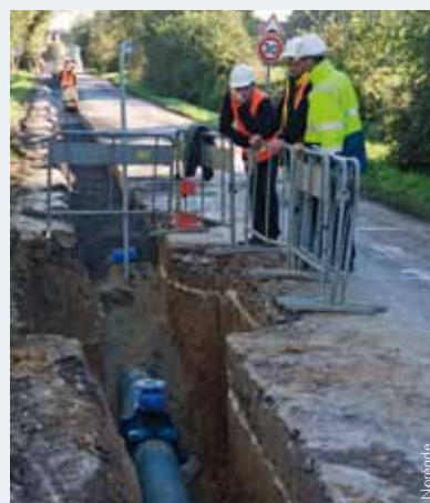
Chaque intervention pour réparer une fuite est géolocalisée.
